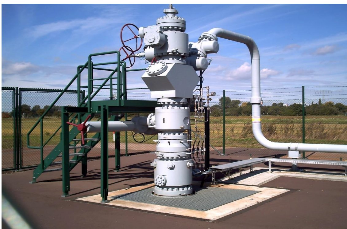
Figura 11: Cabeça de poço após a fase de completção, pronta para produzir. Em detalhe o dispositivo conhecido como "christmas tree".
